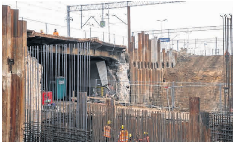
W pierwszej kolejności przebudowywany jest wiadukt w centrum Stargardu. W pierwszym etapie rozebrano połowę obiektu od strony ulicy Szczecińskiej
