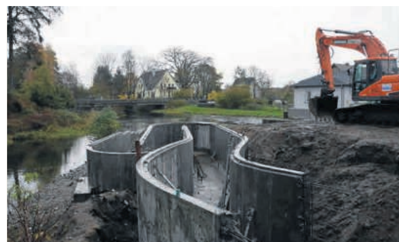
Budowa przepławki. Jej projektowanie nie jest prostą sprawą, bo pod uwagę należy wziąć nie tylko względy techniczne, ale również biologiczne
